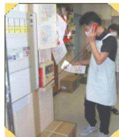
消防署との通報訓練
